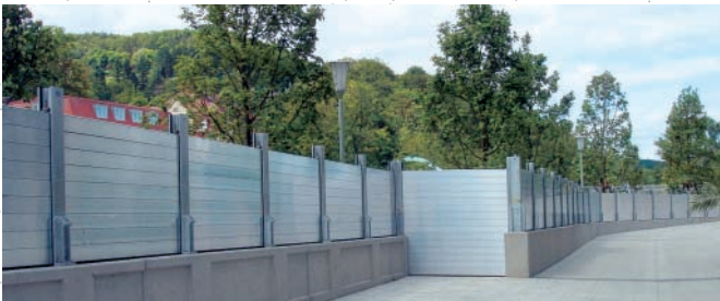
Rosengarten hinter der mobilen HWS-Wand
