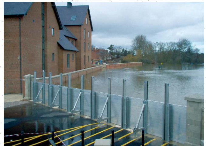
Das mobile Hochwasserschutzsystem bildet ein neues Hochwasserstaubecken.
